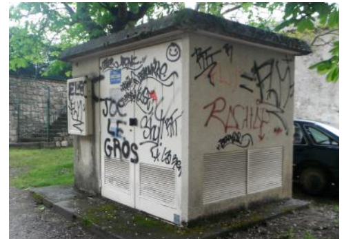
Le transformateur électrique tagué
